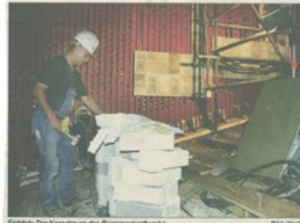
Blick: Der Kesselraum des Biomassekraftwerks. Bild: Weiß
